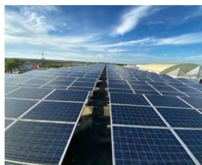
▲ 鹽山倉庫屋頂太陽能板
